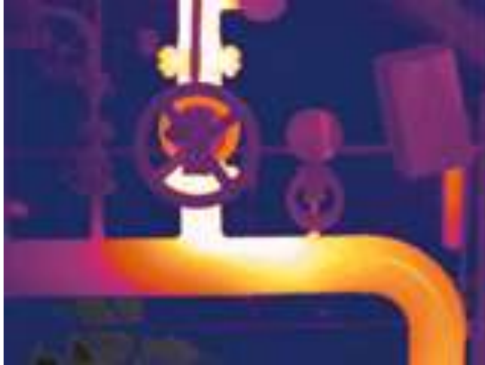
détecter une fuite
